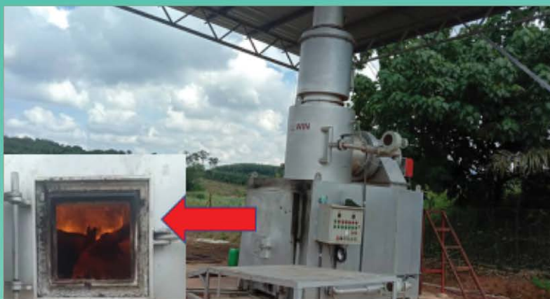
Gambar 5: Incinerator separa automatik (sumber: Ladang Teratai 3, Johor)
